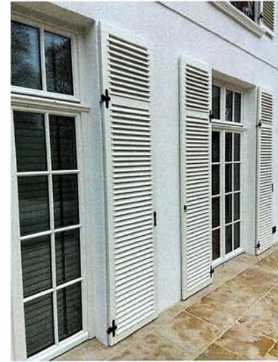
! Weiß lackierte Eiche: Bei einer repräsentativen Villa kam der neue Härter Aqua-Hardener Pro von Adler ...
